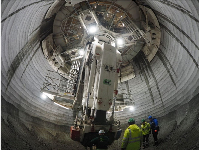
Abbildung 8: Unter-Sicht von der Schachtsohle aus auf den SBR
