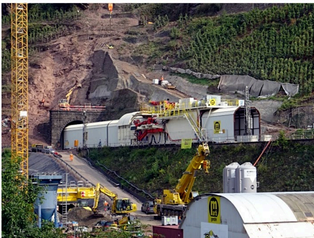
Abbildung 3: Tunnelaufweitungssystem mit Einhausung
