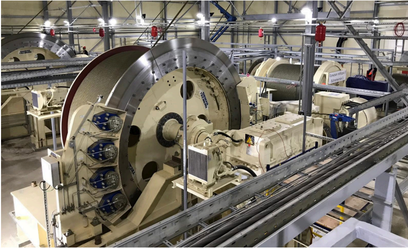
Abbildung 6: Fördermaschinen in Betriebsgebäude
