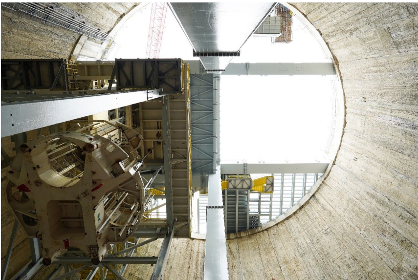
Abbildung 24: Blick nach oben zur Abdeckung des Startschachts mit SBR-Modul (links)
