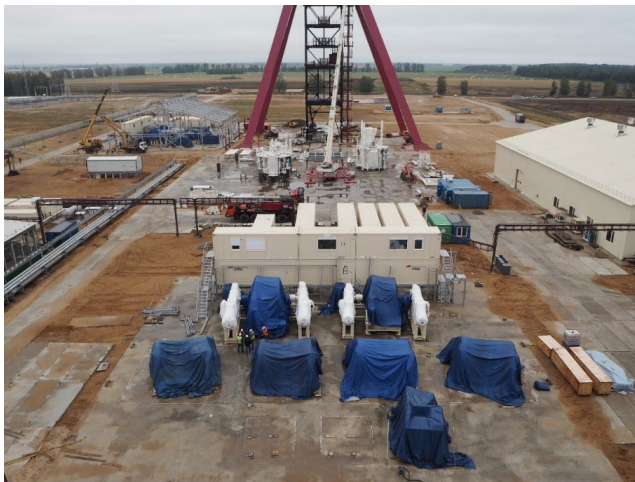
Abbildung 5: Fördermaschinen und SBR-Winden vor ihrem Einsatz
