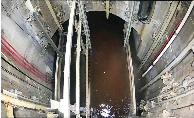
Abbildung 16: Wasserstand im Füllort Schacht 2
